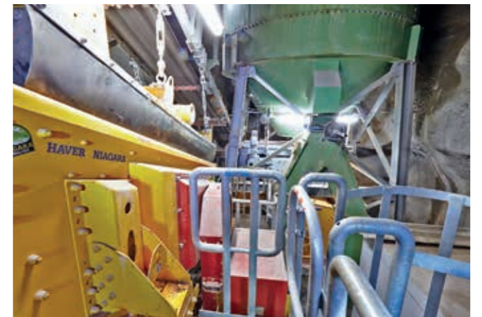
Vorbrechanlage, Fluss- und Feldspat, 80t/h, HAYER F-CLASS, HAYER Schubwagen, Backenbrecher
